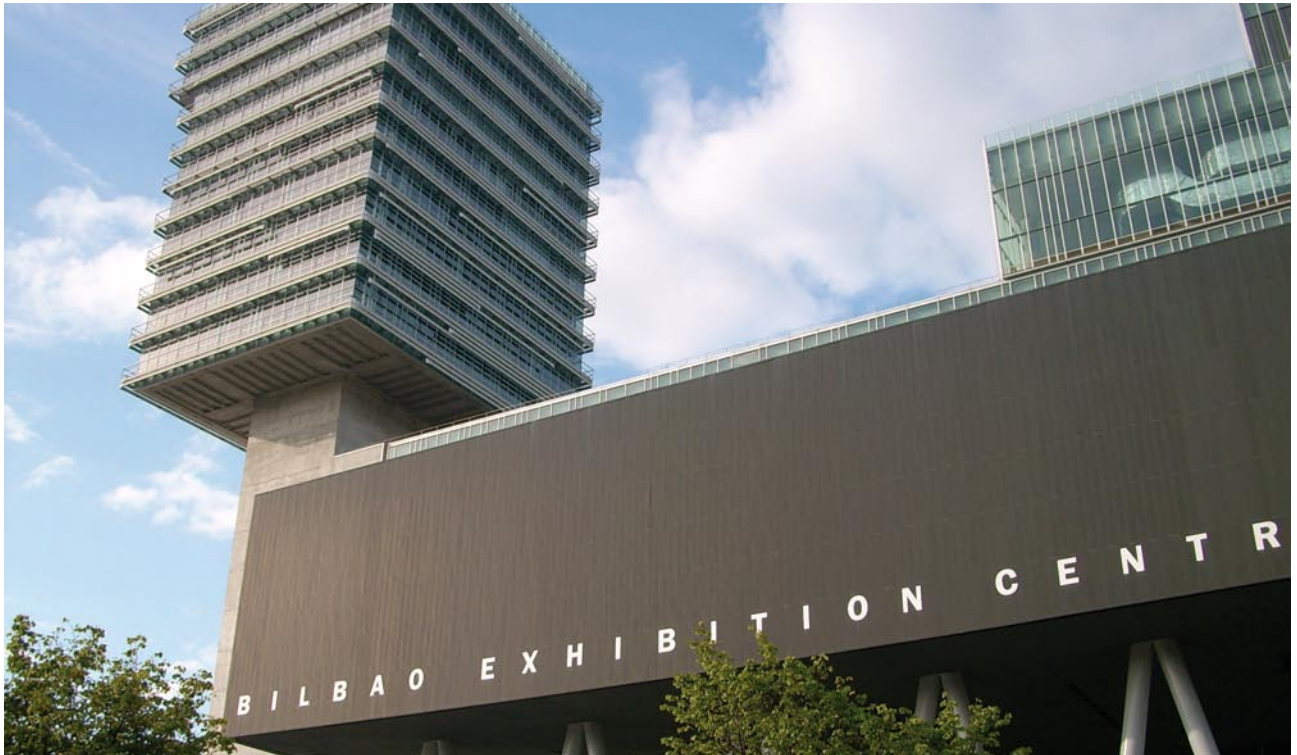
Los arquitectos Esteban Rodríguez y César Azcárate decidieron impermeabilizar el BEC con el sistema bicapa mixto de asfaltado fundido
